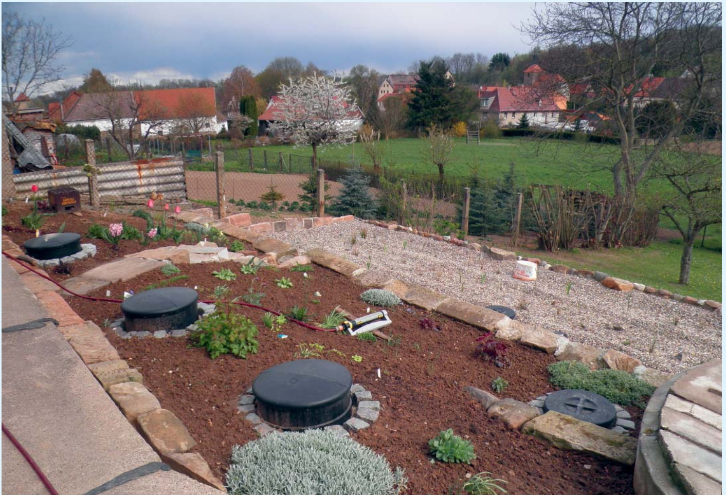
In Betrieb befindliche 8 EW-Anlage mit aerober Nachklärung im südlichen Sachsen-Anhalt
